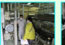
機械室のボイラー等も運転停止
